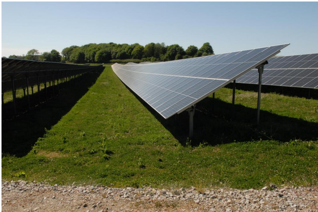
Figur 4. Exempel på solcellspaneler på fasta stativ. Källa: LC Energi.
