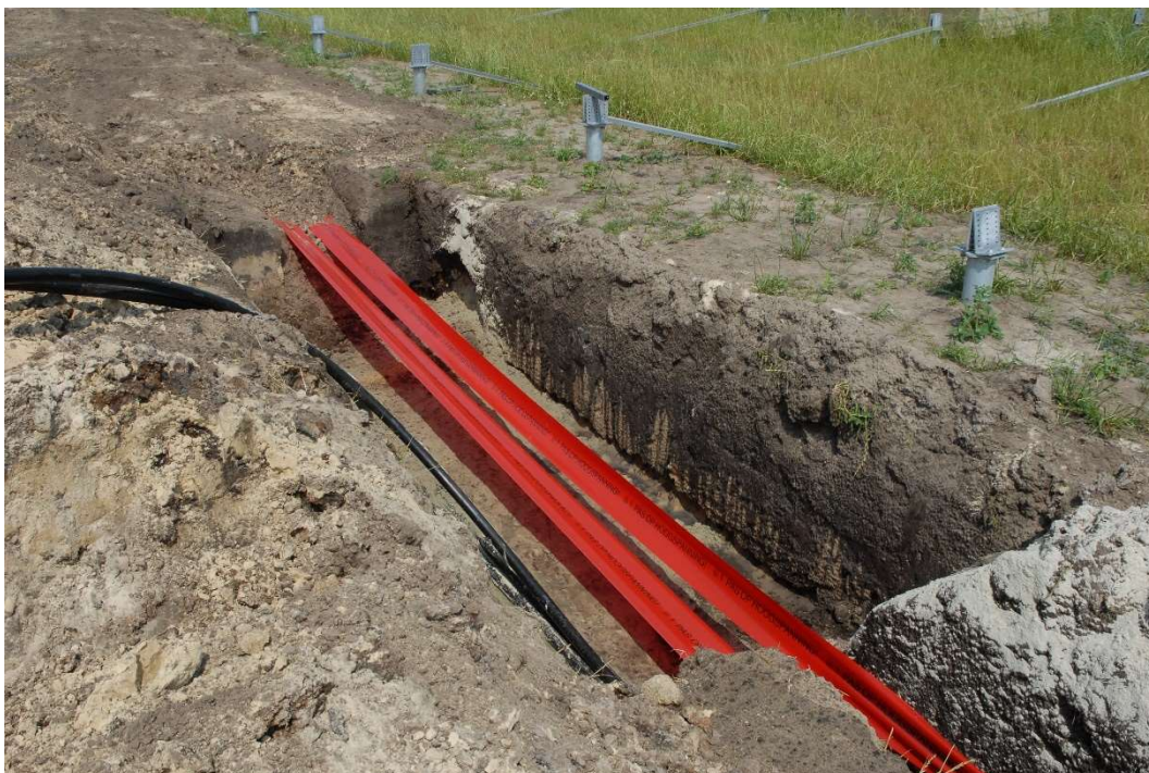
Figur 16. Kabelschakt för mellanspänningskablar (LC Energi, Platsbesök solpark Holland, 2023).
