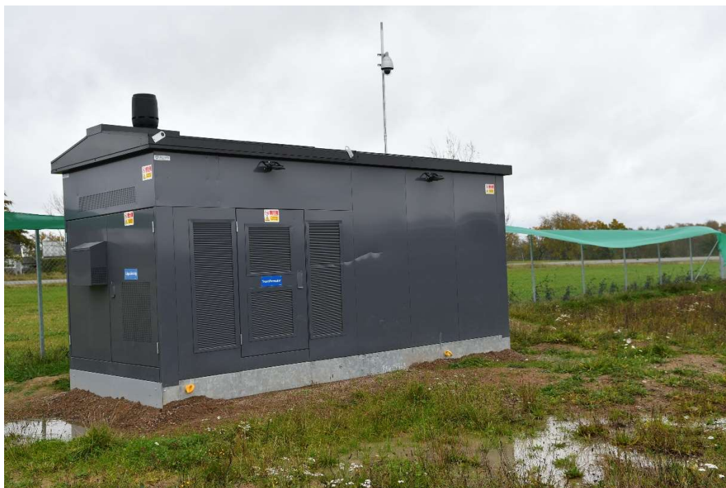
Figur 15. Exempel på en transformator. (LC Energi, Platsbesök Forsby Solpark, 2023).
