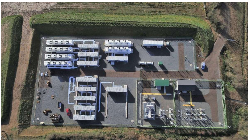
Figur 17 Exempel på batterilager (LC Energi)
