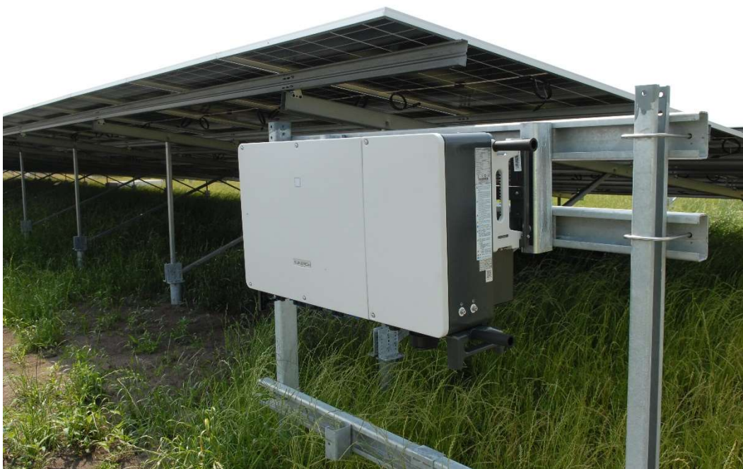
Figur 14. Växeloriktare monterad vid solcellspaneler (LC Energi, Platsbesök solpark Holland, 2023).
